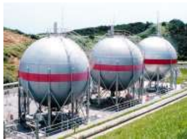
液化水素貯蔵タンク
